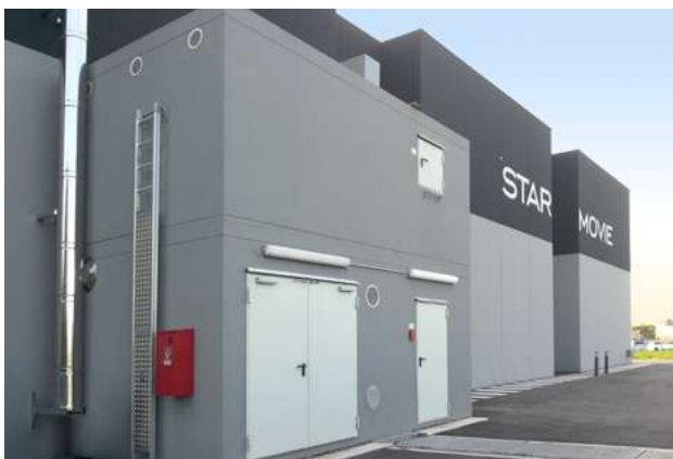
Doppelstock-Heizmodul 200kW Hackgut, Gewerbe
