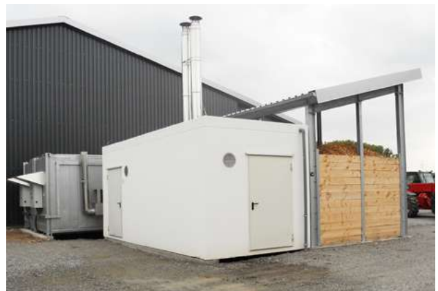
Einstock-Heizmodul 2 x 100kW Hackgut, Gewerbe
