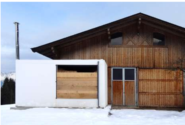
Einstock-Heizmodul 35 kW Hackgut, Landwirtschaft
